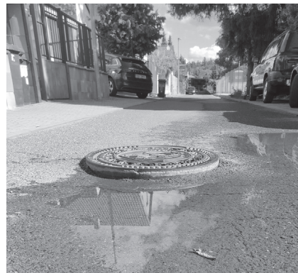
Výtluky v ulici Nové domy
